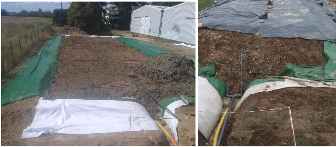
Figure 5: Vues sur le biotertre et le premier réseau d'extraction
